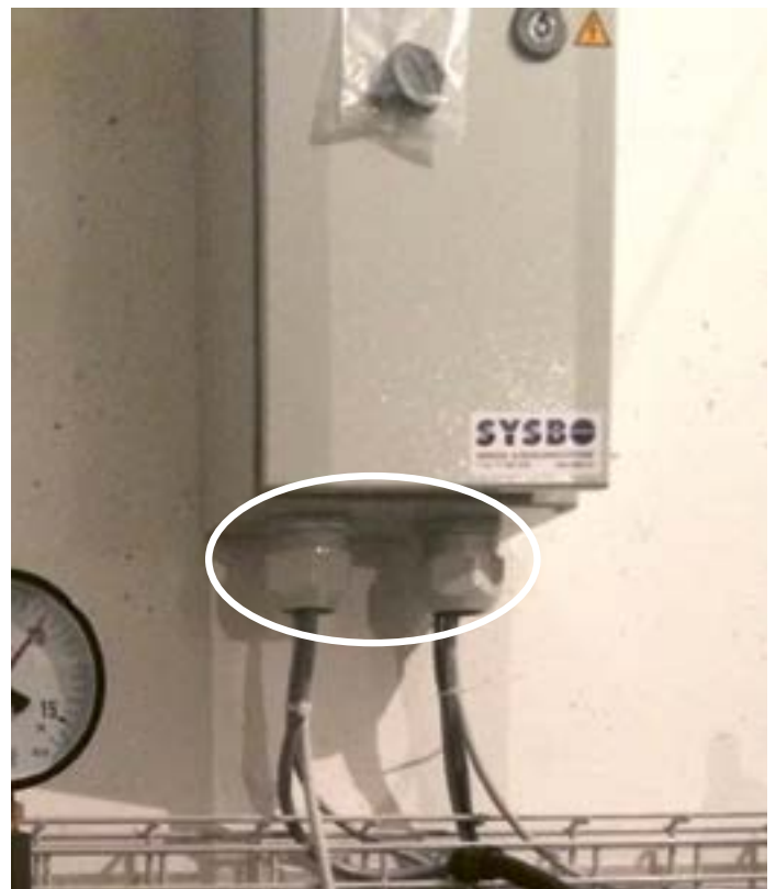
Beispiel einer Kabeleinführung beim Standard-Gehäuse. Platzreserve auf Klemmschiene bei Bedarf! (Erlaubt optimale Platzausnutzung im Gehäuse.)
